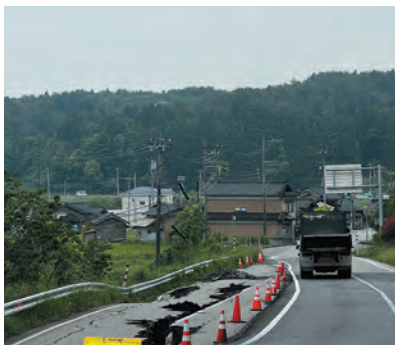
まだまだ震災の爪痕が残る一般道。地割れ、がけ崩れ、飛び出したマンホール、傾いた信号機などがいたるところで見られた。夜間の運転は道になれた地元ドライバーでも注意が必要だそうです。
